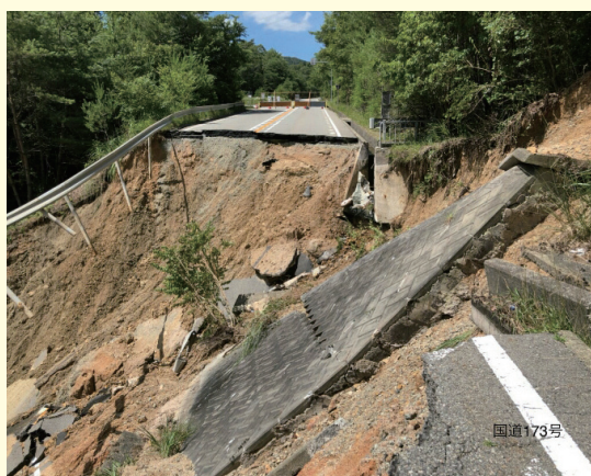
国道173号で、道路のアスファルトごと崩落
