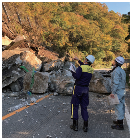
R173の法面崩落現場 (能勢町・天王付近)
