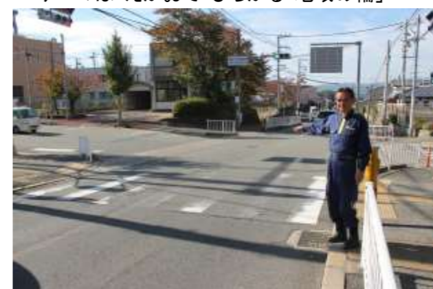
豊能町R477号の吉川交番移設、右折レーン設置 の交差点工事は、平成29年6月完了の予定です。
