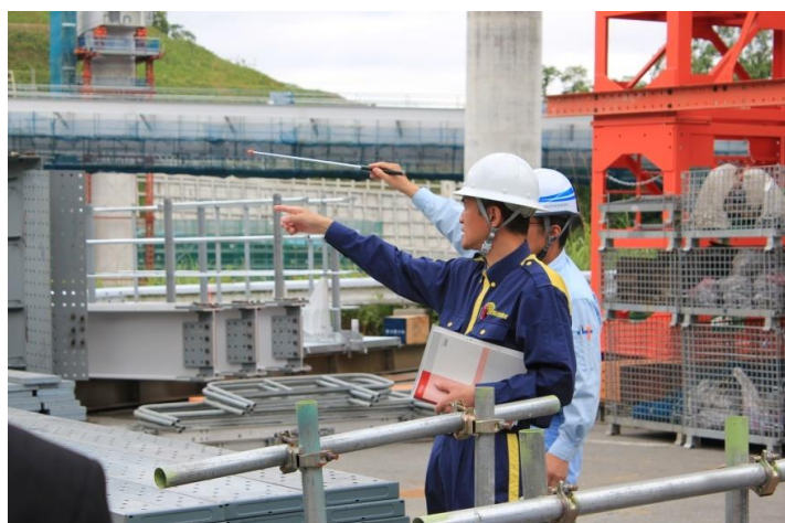
平成28年5月 新名神高速道路建設中の事故現場を検証
